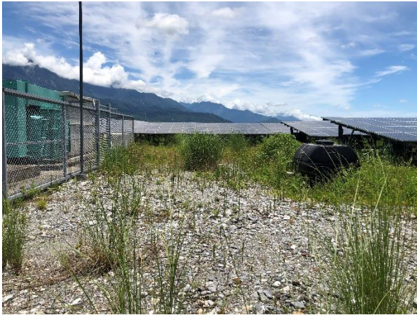
圖 18 南端東側單元變電站周邊環境照片
