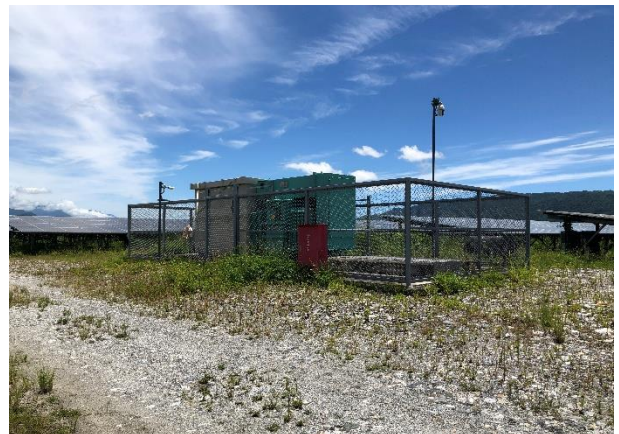
圖 17 南端東側單元變電站周邊環境照片
