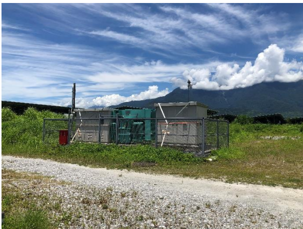
圖 20 北端西側單元變電站位置
