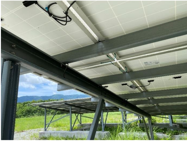
圖 2 光電板線材樣貌
